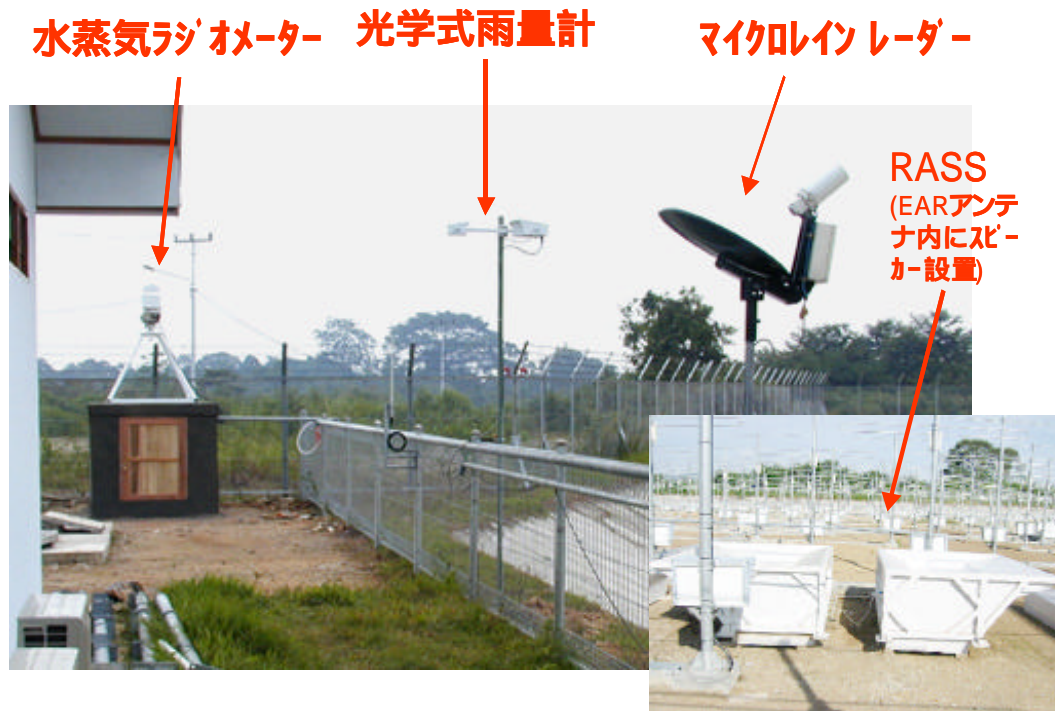
図 2.2001 年度に設置された (整備中も含む) 観測機器の外観と配置 .
